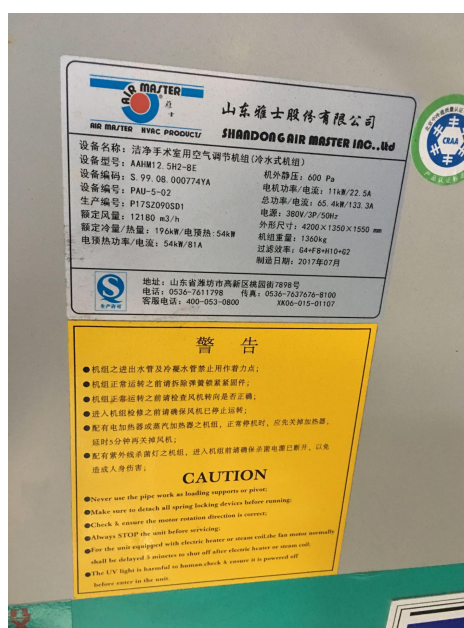
手术室空气净化系统
